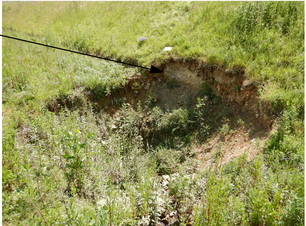
Remblai aval hétérogène
