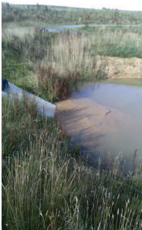
Figure 1 : lessivage de fines en entrée de bassin BM 20.2
