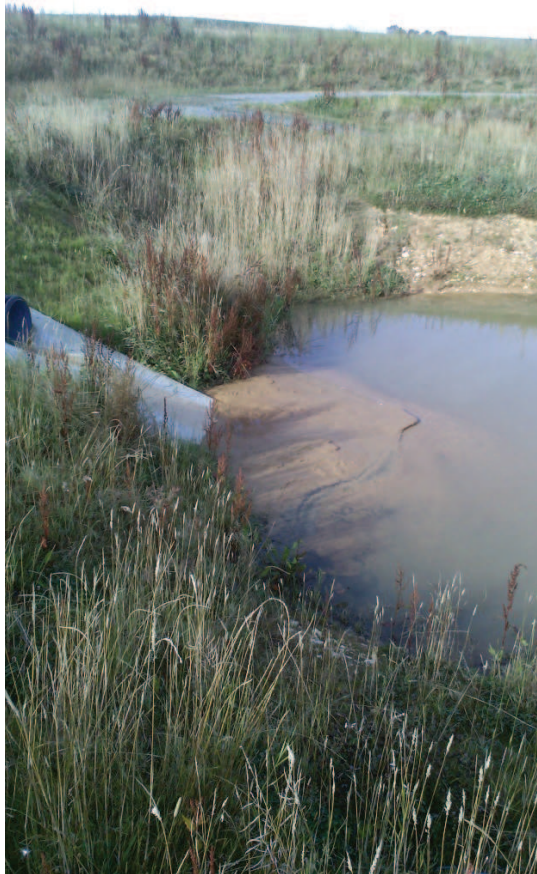
Figure 1 : ravinement et arrivée de fines dans le bassin 20.2
