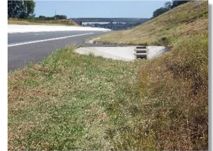
Photo 12- Réseau latéral de collecte des eaux pluviales – Cunette dissymétrique– PR15.42
