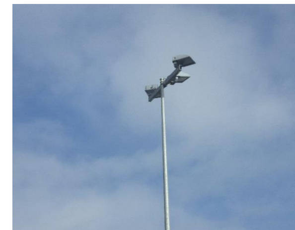
Photo 57 - Capots réflecteurs lampadaire BPV (Photo RBC Projet septembre 2016)
