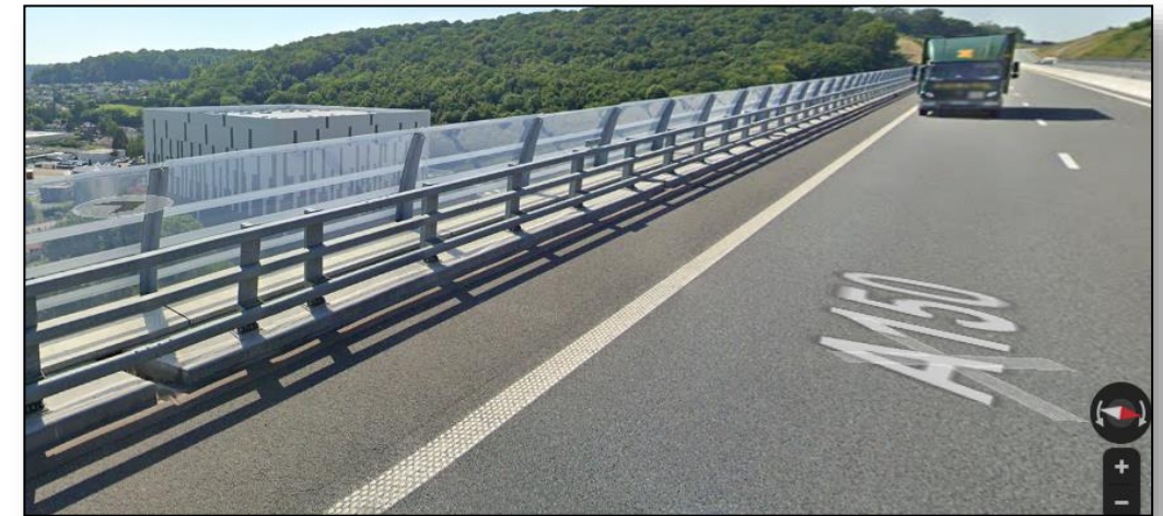
Photo 4 – écran acoustique translucide tablier viaduc de l'Austreberthe - commune de Barentin – PR13.90 (source photo – Google Earth Pro)
