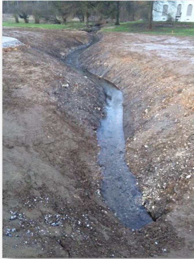
Photo 33 - Remise à l'air libre et reconstitution d'un lit naturel de la source rive gauche à la fin des travaux de construction du viaduc de l'Austreberthe (Photo INGEROP – Février 2015)
