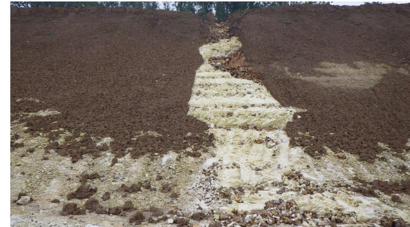
Photo 18 – Érosion de talus – photo extraite rapport LIMANDAT Mai 2014
