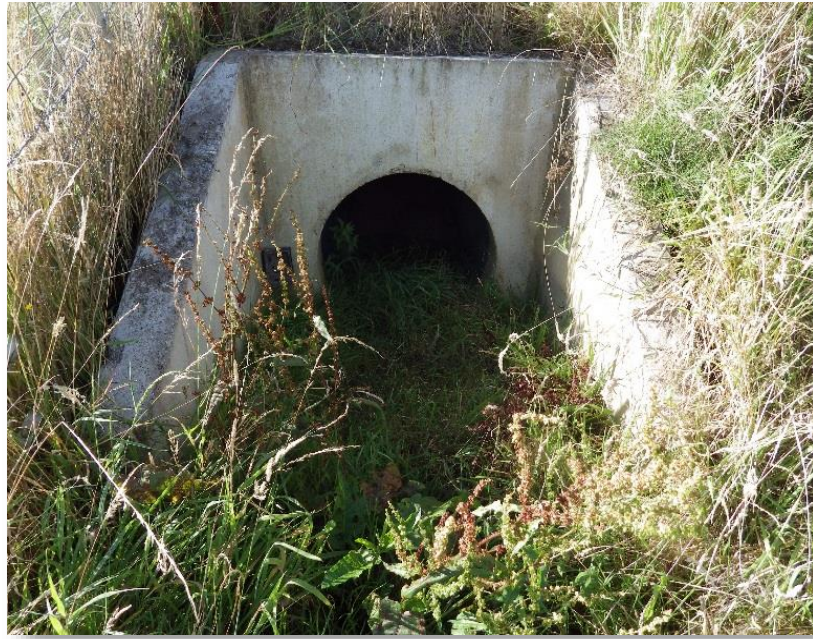
Photo 32 - PPF1900 – côté Ouest – PR26.78 – secteur du Bel Évent Flamanville (Photo RBC Projet Août 2016)
