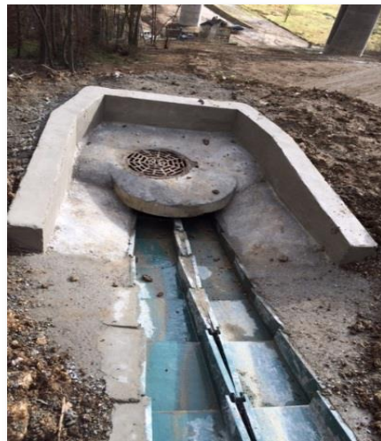
Photo 21 – Réhausse d'une couverture d'avaloir – coteau Nord Austreberthe (photo INGEROP – 2015)
