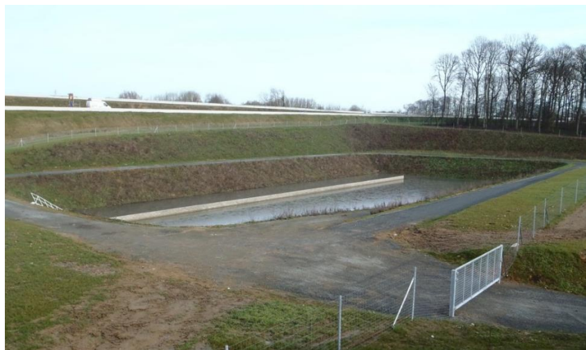
Photo 13 - Bassin multifonctions BM11.9 diffuseur de Barentin – PR11.90 (Photo RBC Projet – Janvier 2015)
