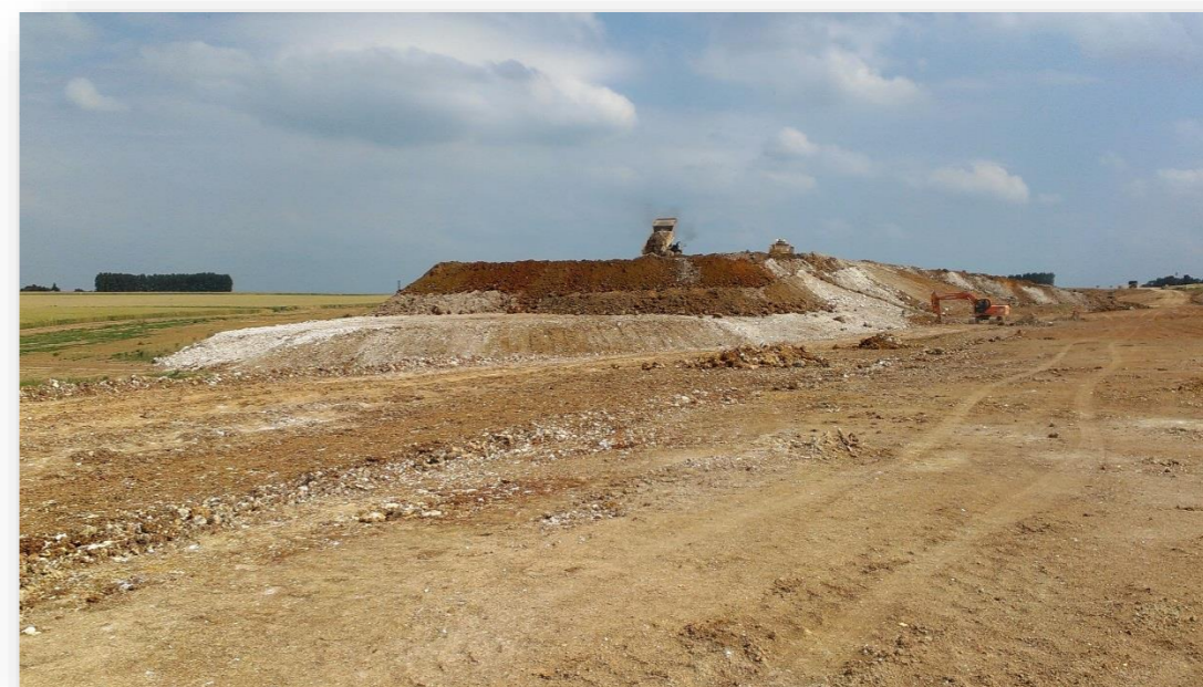
Photo 31 - Dépôt provisoire de matériaux servant à la couche de forme- Bouville (Photo RBC PROJET Juillet 2013)
