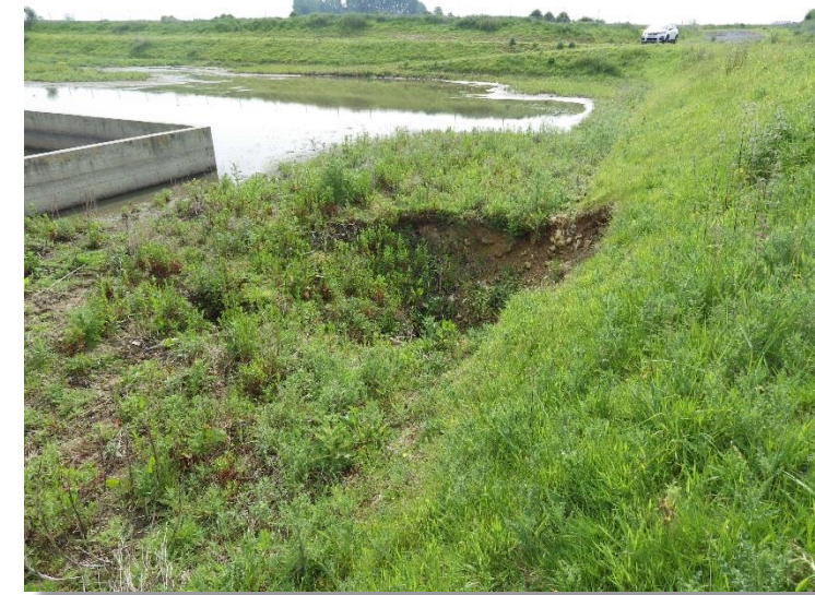
Photo 6 - Effondrement dans le bassin BM109.2 – PR17.87 – Avant travaux
