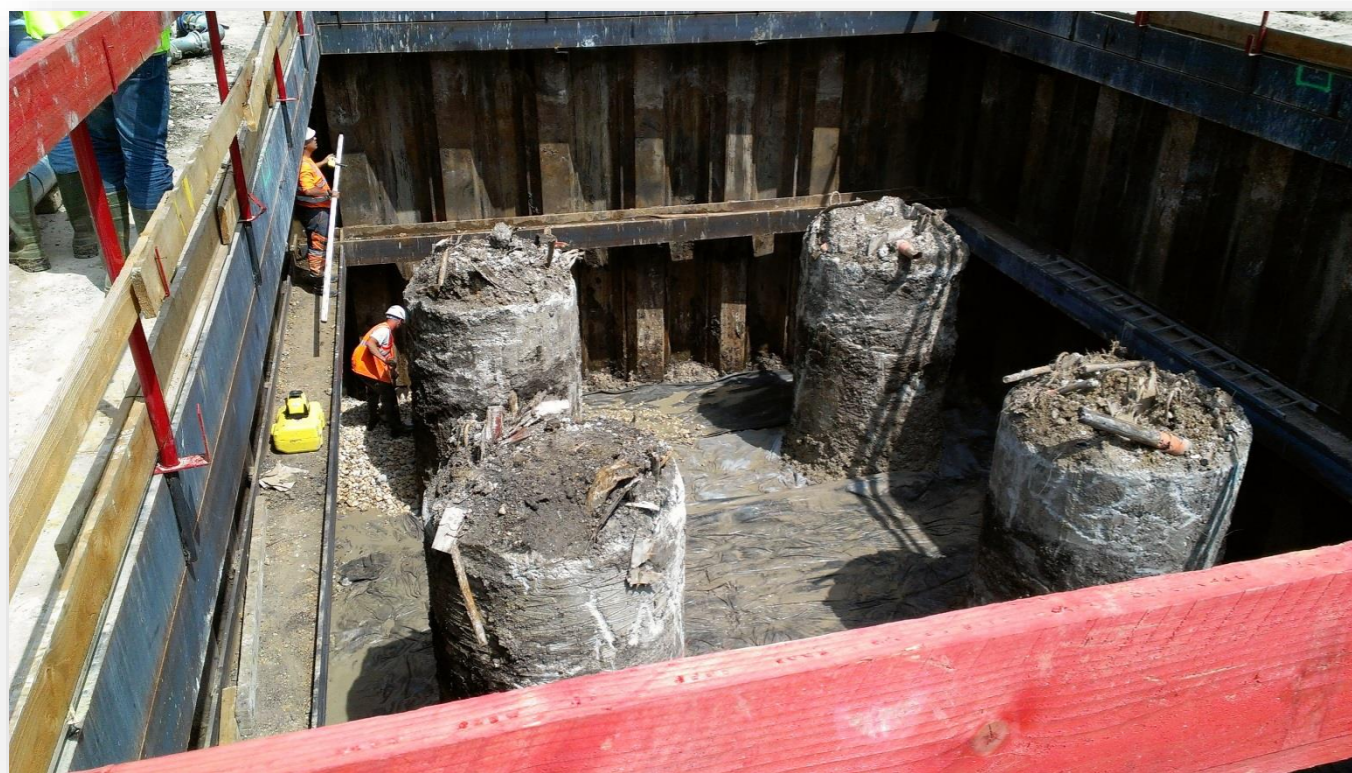
Photo 35 - Batardeau pour la réalisation des fondations par pieux forés à sec de la pile P3 du viaduc de l'Austreberthe (Photo RBC PROJET – Juillet 2013)
