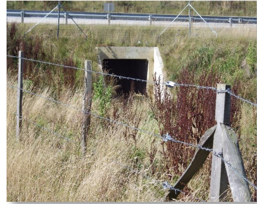
Photo 34 - PPF3280 au PR25.26 débouché sur Zone humide – Motteville (Photo RBC Projet Août 2016)
