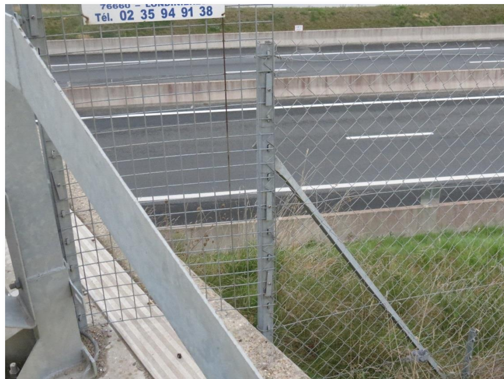
Photo 45 – Raccordement de la clôture aux équipements de sécurité de l'ouvrage de rétablissement de la RD20 – PR25.50 – photo RBC Projet septembre 2020
