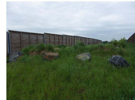
Photo 78 – enrochements déposés à l'entrée du PGF du Bel Événement (PR26.60) pour empêcher le franchissement des voitures – Photo RBC Projet mai 2018
