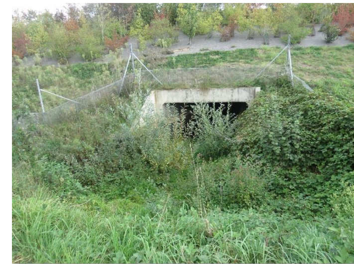
Photo 88 – entrée Ouest de PPF de la Charrue PR17.92 obstruée en partie par la végétation – photo RBC Projet septembre 2020
