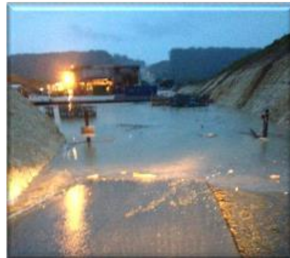
Photo 21 - Inondation de la culée C0 du viaduc de l'Austreberthe en mai 2014
