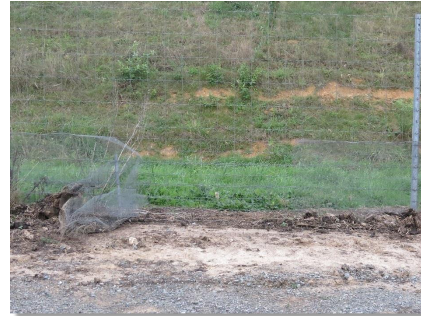
Photo 91 – clôture petite faune endommagée au PR24.38 – photo RBC Projet septembre 2020
