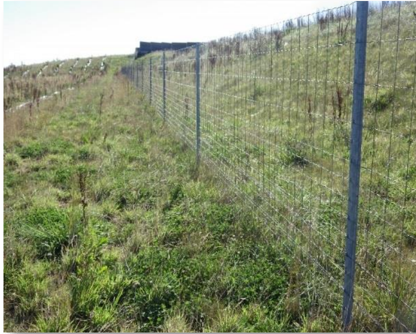
Photo 41 - Clôture Grande faune à mailles progressives – PR26.76 (Photo RBC PROJET Août 2016)
