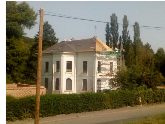
Photo 55 – Aménagement du Siège Centre Eau Risques Territoire (CERT) avec le concours de l'aide au titre du 1% paysage de l'A150 Barentin /Ecalles Alix – Maitre d'Ouvrage Syndicat Mixte des Bassins Versants de l'Austreberthe et du Saffimbec (SMBVAS).
