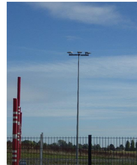
Photo 56 - Mat lampadaire section courante BPV – PR16.08 (Photo RBC Projet septembre 2016)
