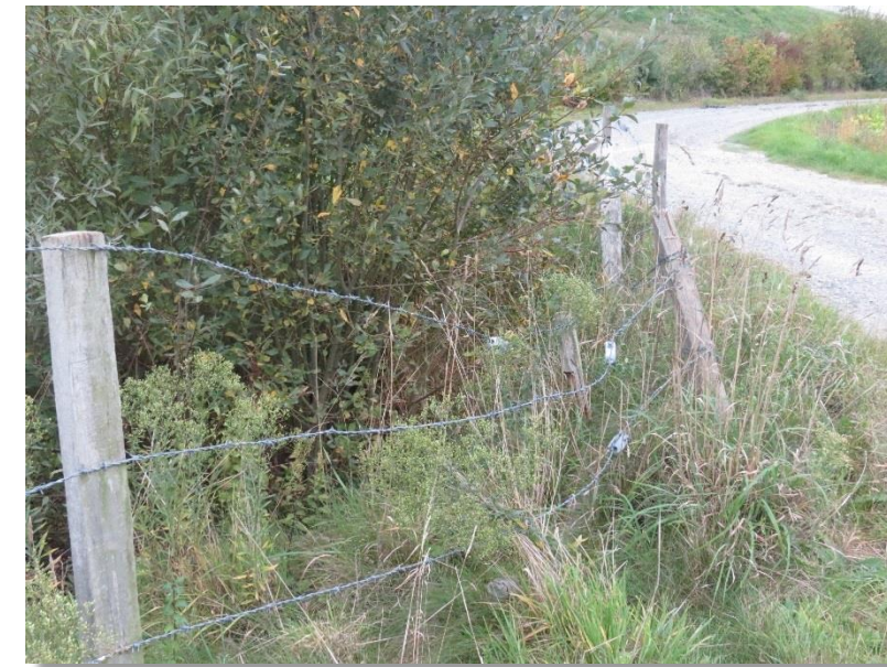
Photo 92 – clôture herbagère endommagée au PR24.42
