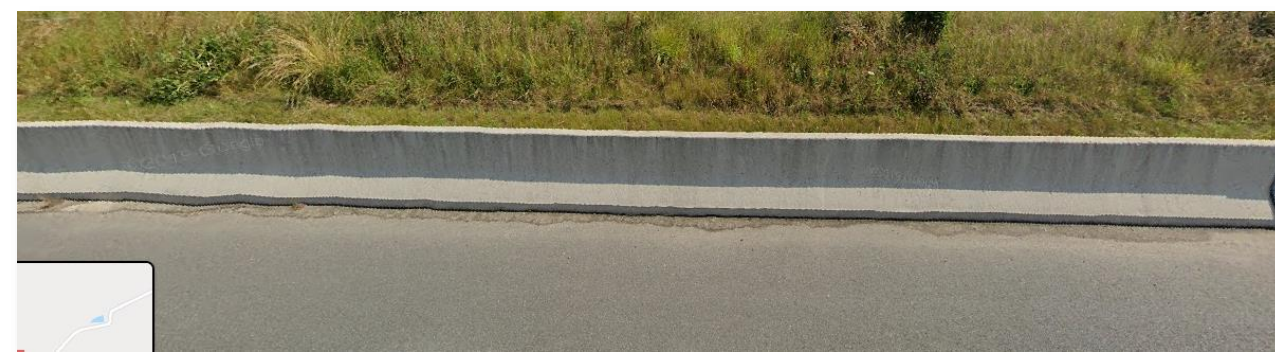
Photo 16 – Présence de dépôt de gravier laissant supposer une stagnation d'eau en pied de GBA
