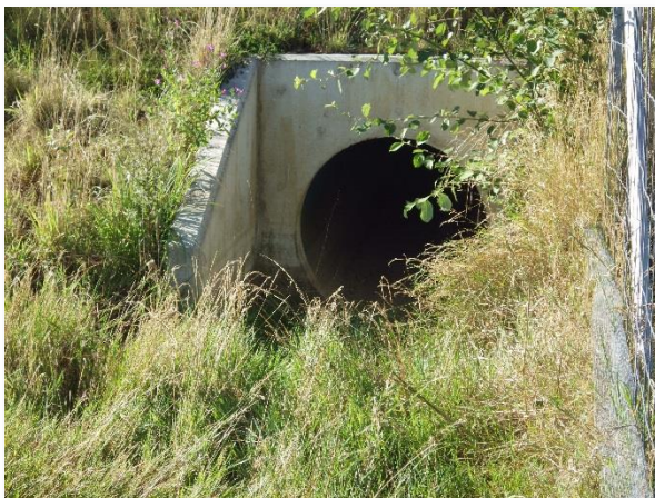
Photo 24 – Ouvrage hydraulique de type buse PEHD – PR26.78 (Photo RBC Projet Août 2016)
